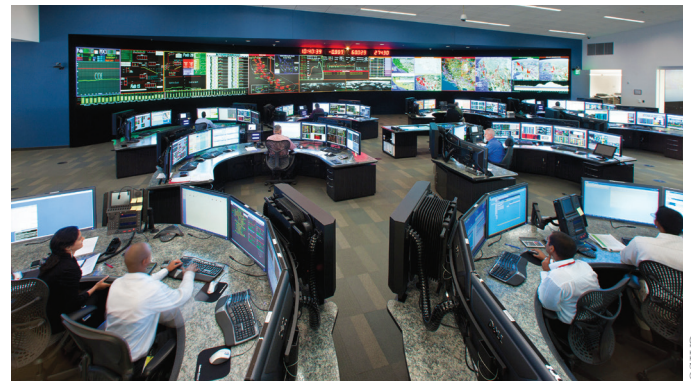
En el centro de control de operaciones del California Independent System Operator (CAISO) el suministro y demanda de electricidad están constantemente equilibrados para mantener la confiabilidad.
